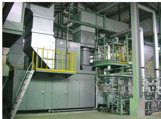
コージェネレーションシステムによるガスタービン発電機
