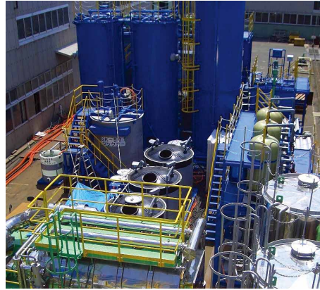
坑廃水処理装置
