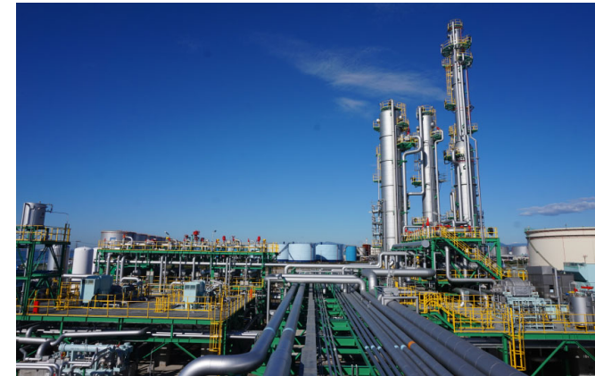
苫小牧実証プロジェクト地上設備 写真提供：日本CCS調査(株)
