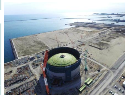
■ Soma LNG terminal Panoramic view of the LNG tank and landfill
