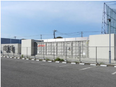
JAPEX美浜蓄電所
