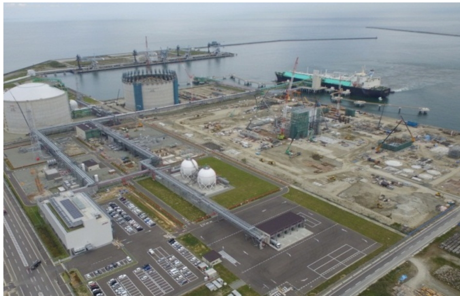
△相馬LNG基地と福島天然ガス発電所 (2018年10月累計第4船入港時)
