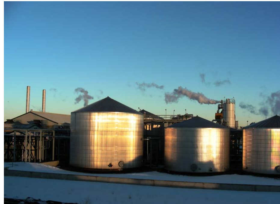
JACOS ビチューメン生産施設(3.75セクション)
