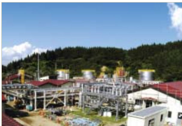
生産処理設備増強工事中の由利原鉱場（秋田県由利郡由利町）
