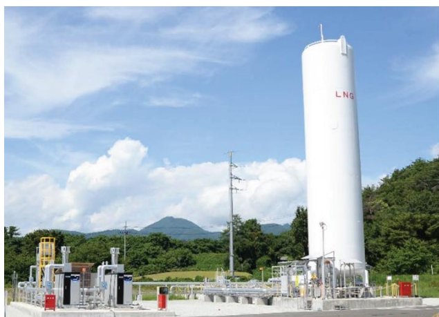
Sakurambo Smart Energy LNG Satellite Station
